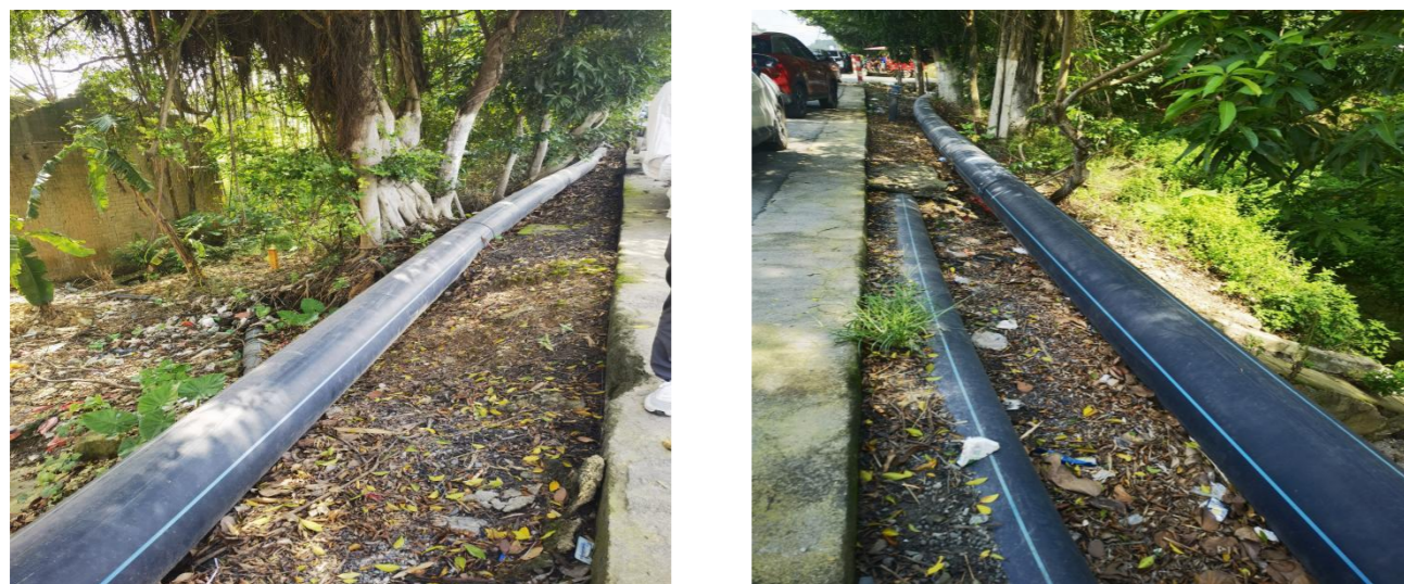
图5 玉石公路现状给水管
